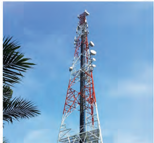
> Menara Telekomunikasi PDC Telco
