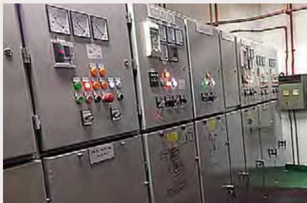
Panel elektrik untuk sistem penyejuk
